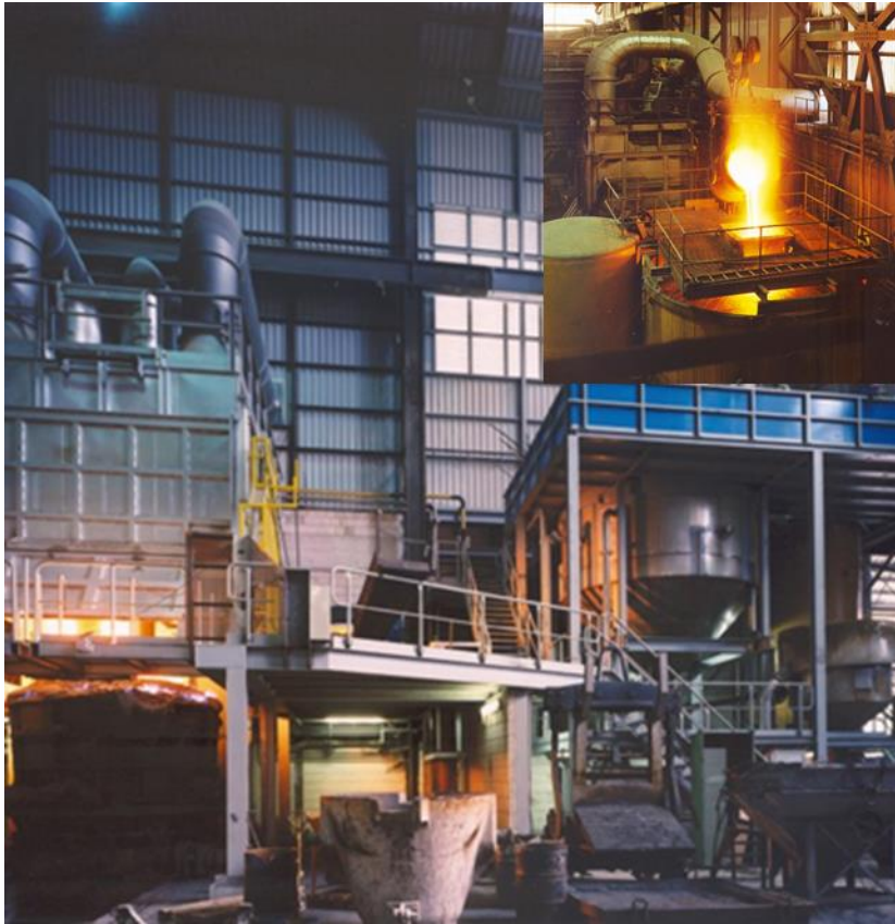
Lichtbogenofen und Ganulieranlage
